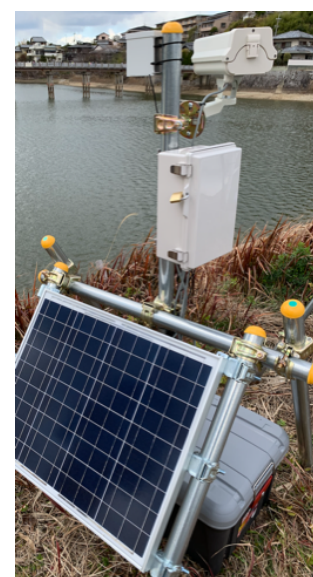
Fig.3 観測機器の設置状況
